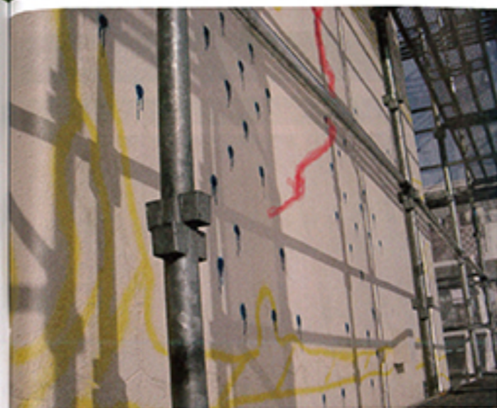
壁面を丁寧にチェックして補修箇所をマーキング。赤はクラック（ひび割れ）、青はモルタル下地厚さ、黄は「めくり」といって、超高压水流でモルタル塗膜を全部剥がし、一から塗り直す箇所
