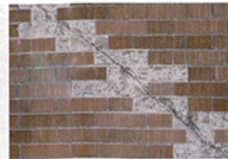
タイルの上から見たらヘアークラック（髪の毛ほどの細いひび）だったが、タイルの下にクラックが見つかった例。コンクリート中性化防止のために、早めの修復が必要だ
