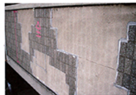
見た目ではわからなかった壁面のタイルが大きく剥離した現場。残るタイルもコンクリート躯体との間に「浮き」が見られ、全部剥がして張り直すことになった
